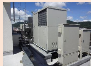
自家発電システム
